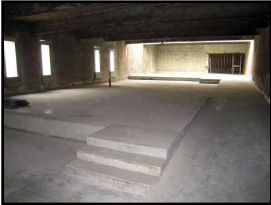
Poursuite des travaux de maçonnerie à l'autre bout du bâtiment pour les futurs locaux communs.
